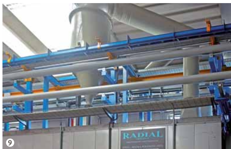
Figura 9: Uno dei camini di estrazione dei fumi dal tunnel di pretrattamento.
