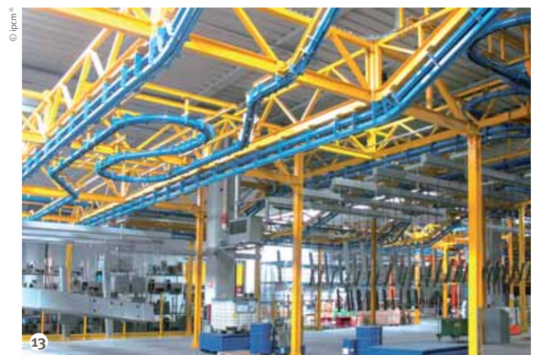
Figura 13: Il polmone di accumulo prima della zona di verniciatura a polveri.
