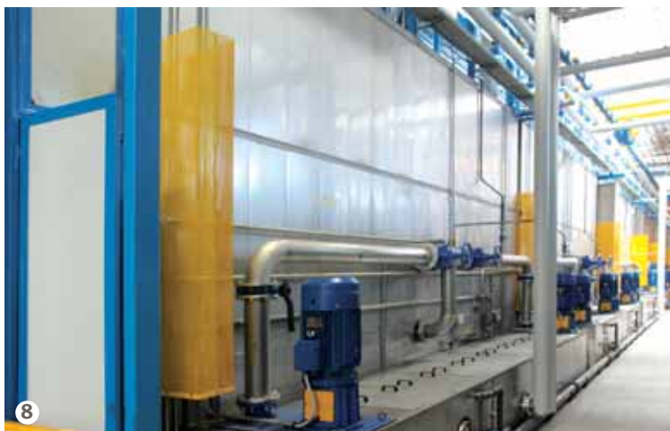
Figura 8: Il tunnel di pretrattamento.
