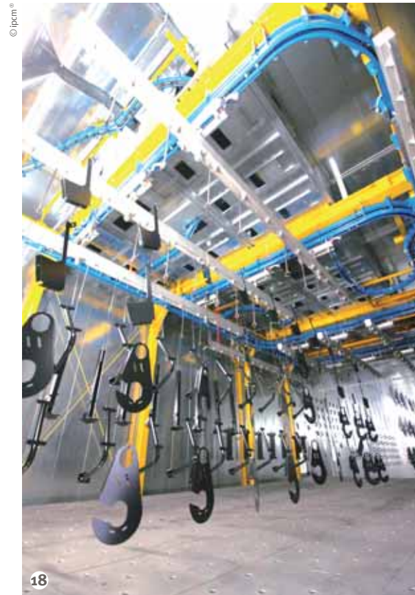
Figura 18: La zona di raffreddamento dei manufatti trattati.
